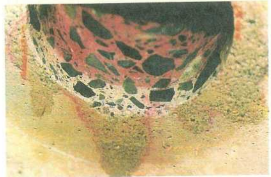
写真-1 建物基礎のコンクリートにおける炭酸化の進行
