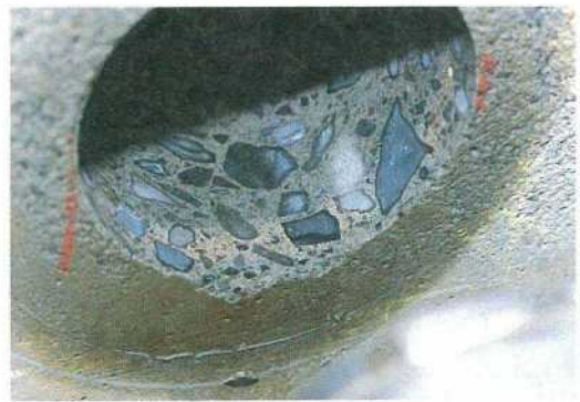
写真-3 建物基礎のコンクリートにおける変色現象
