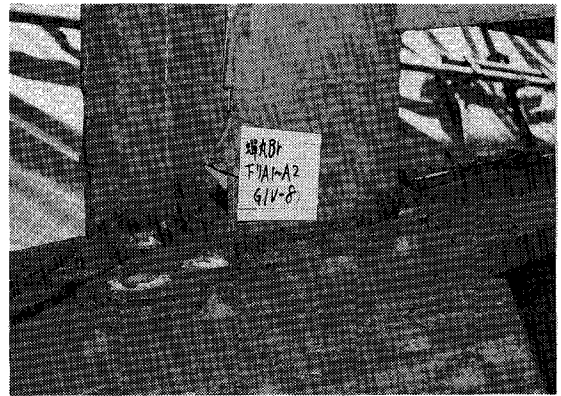
写真-1 垂直材下端クラック
