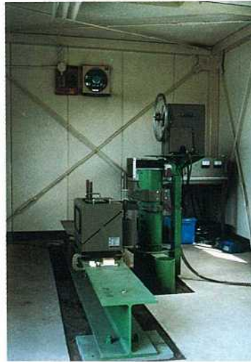
写真-10 地盤沈下・地下水位観測装置
