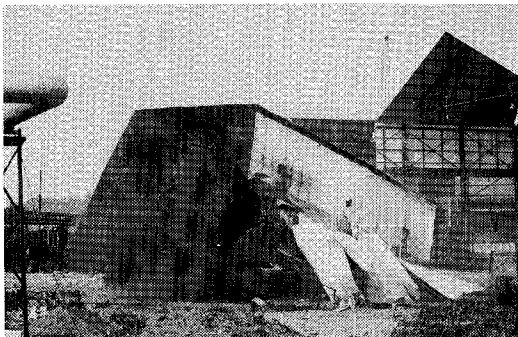
写真-5 CASE 4 桁行方向水平倒壊形式の倒壊
