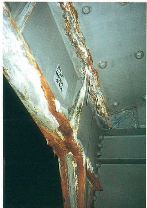
写真-2 床版下面の漏水と鋼板腐食の事例(鋼板接着工法)
