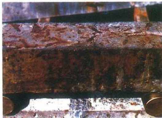
写真-3(b) 暴露5年時点におけるSFRCの表面状態
