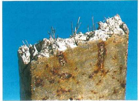
写真-4(a) 暴露5年のSFRCの断面と表面状態 (異形カットワイヤー)
