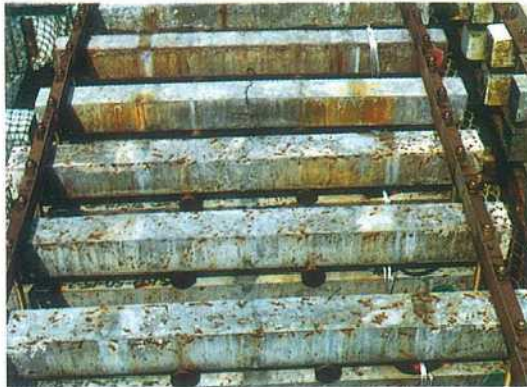
写真-3(a) 暴露5年時点のSFRCの外観
