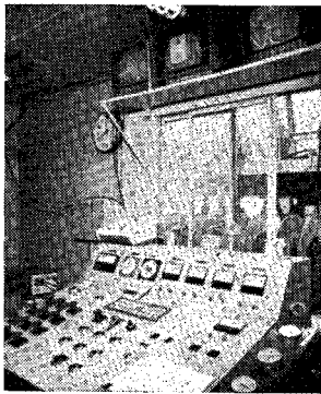
写真-4 アーム式水中掘削機運転制御室
