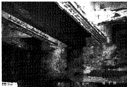
写真一6 チリ国V港の栈橋劣化の例 (はり下部の被りコンクリートは剥落しているが壁部は比較的健全)
