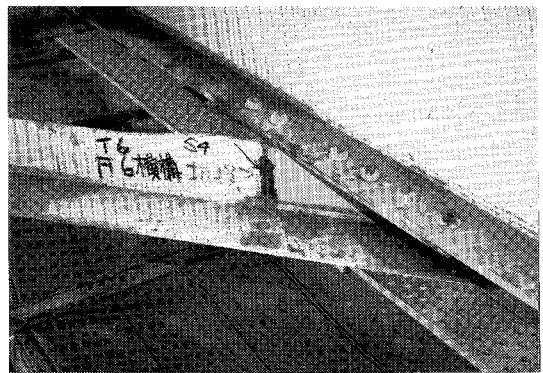
写真-12 下横構の破断
