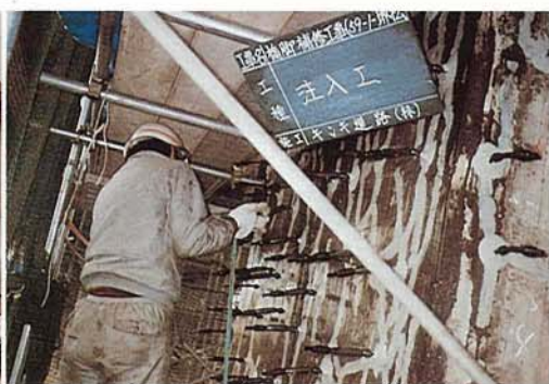
写真—10 (右) ひびわれの樹脂注入の状況 部に多数発生したひびわれ 写真—8 (左) 鉄筋の比較的少ない擁壁
