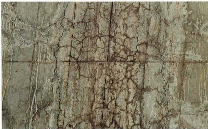
写真一6. 橋脚柱部に発 現した不規則な亀甲状の ひびわれ
