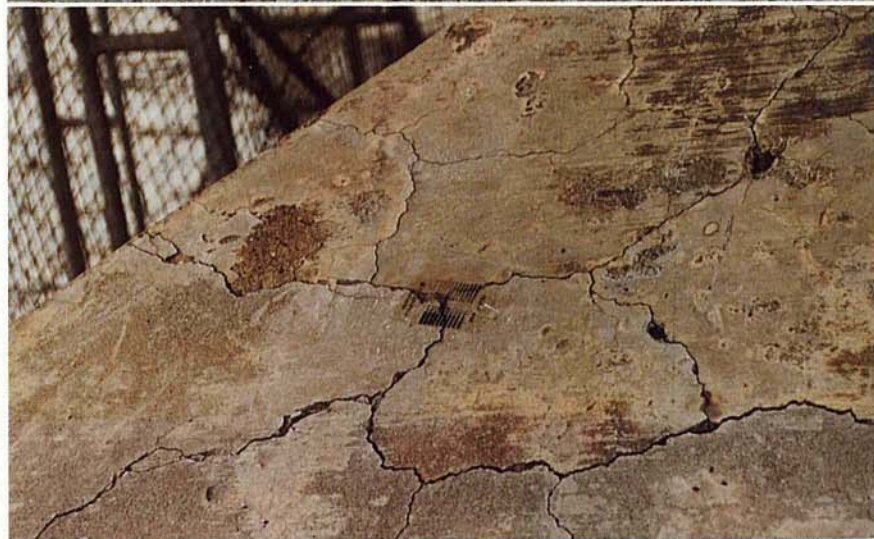
写真一7. 鉄筋の少ない 部材の表面に発生した典 型的な亀甲状のひびわれ
