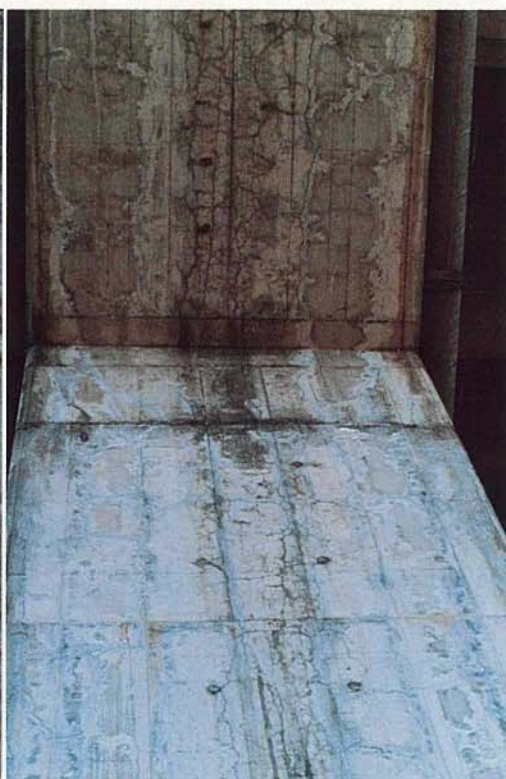
写真—5 範囲に帯状にひびわれが発生している (右) T型橋脚を見上げたもので、上部工の架設までに雨水の通り道になっていた 写真—4 (左) 橋脚柱部に鉛直方向に生じたひびわれ
