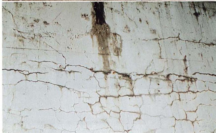
写真一9. 鉄筋の比較的 少ない擁壁部に多数発生 したひびわれ
