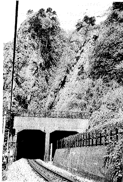
写真-1 検証例1の状況
