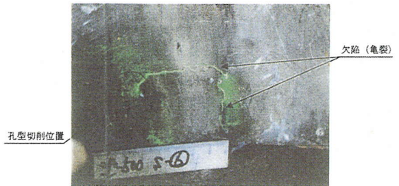
図-13 円柱梁ウェブ貫通タイプの損傷
