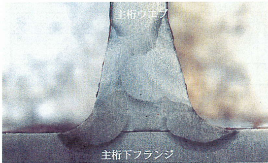
写真-17 主桁首溶接補修溶接部マクロ
