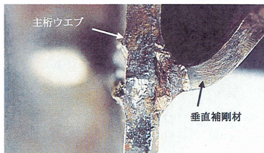
写真-15 亀裂(1-2)破面
