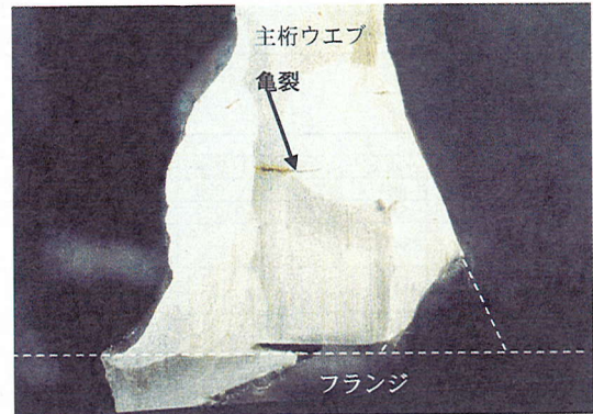
写真-19 主桁桁端切欠部亀裂補修部マクロ
