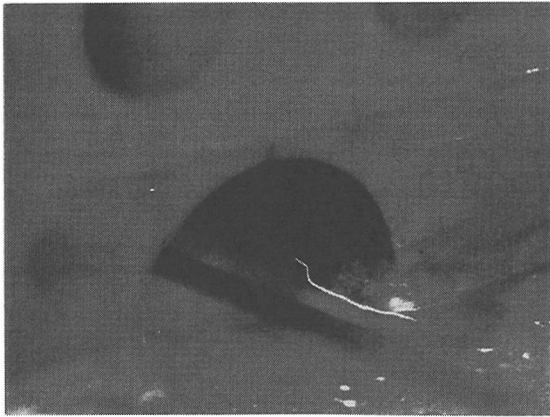
写真-5 亀裂発生状況(磁粉探傷試験)
