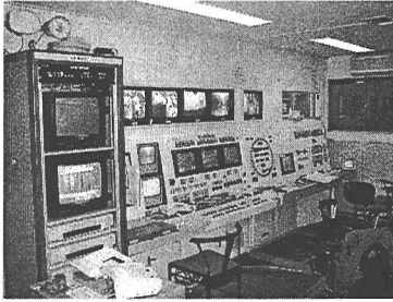
写真-8 シールド機運転室
