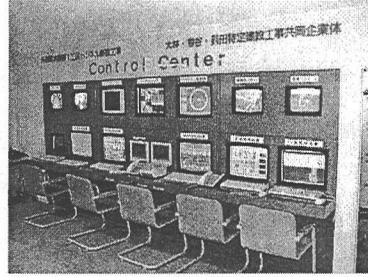
写真-9 中央制御室
