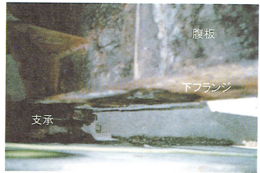
図-4 下フランジ下面に発生した層状錆
