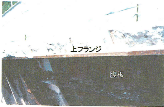
図-3 上フランジ、腹板（内面）の状況
