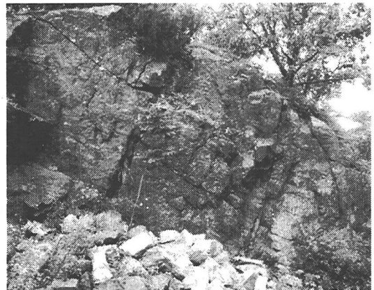
写真-2 亀裂分布を調査した岩塊の露头
