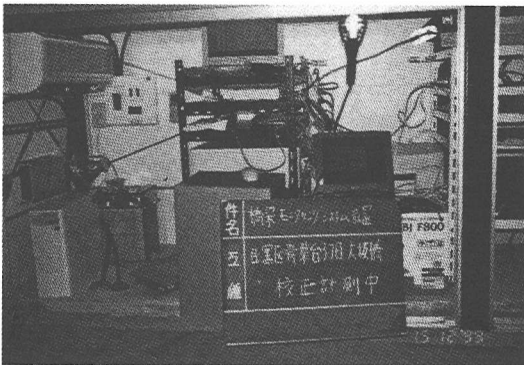
図-11 測定機器の設置状況
