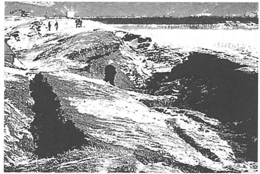
写真-3 十勝川堤防の被災(右岸 統内地先)
