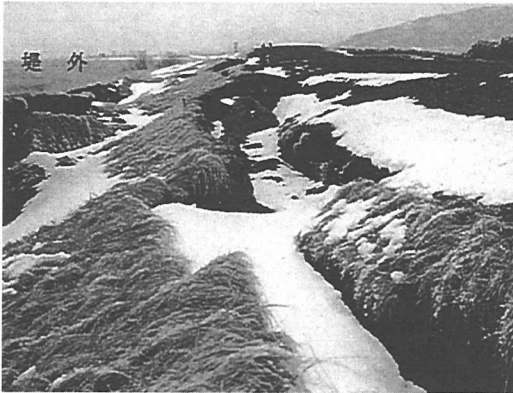
写真-2 釧路川堤防の被災(遊水地左岸 KP9.8km)
