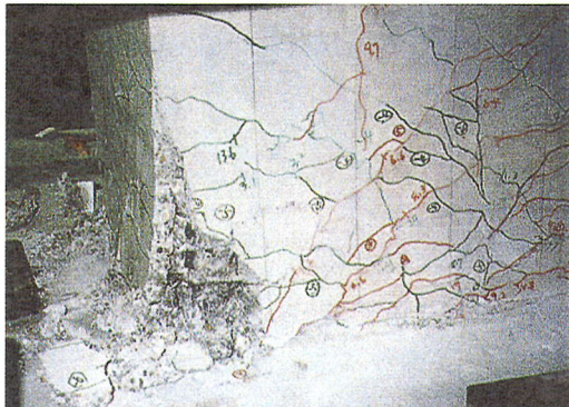
写真-1 No.1 柱基部での損傷
