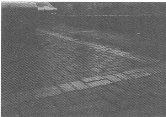
写真-1 ブロック間の段差例
