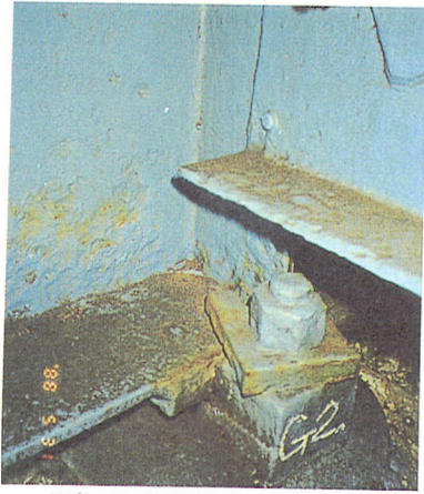
写真-1 桁端部における腐食事例
