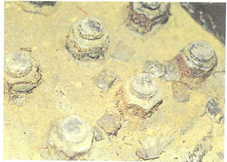
写真-6 高力ボルト継手部の腐食
