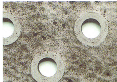
写真-10 錆を除去した腐食面の状況
