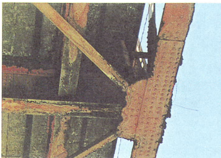
写真-4 下路トラス橋の格点部の腐食
