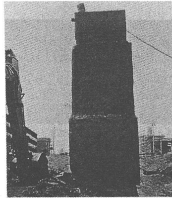
写真-1 換気塔被害の全景
