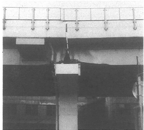
写真-5 桁端橋部の橋軸直角方向への屈服
