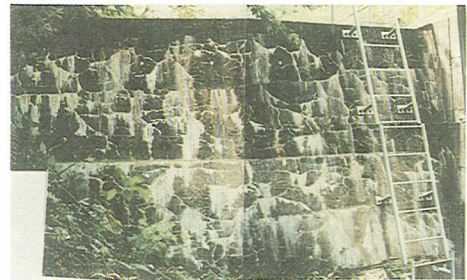
(b) 背面劣化状況(右岸)
