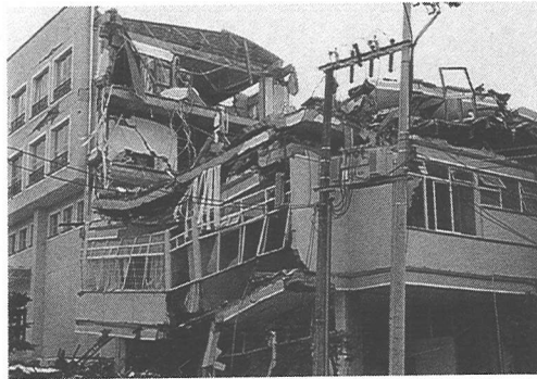
写真-2 独立柱化した細長い柱が座屈した建物 (提供:E.Rodriguez grandos)
