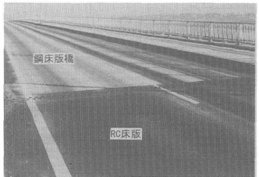
写真-1 鋼床版とコンクリート床版の結露凍結の違い
