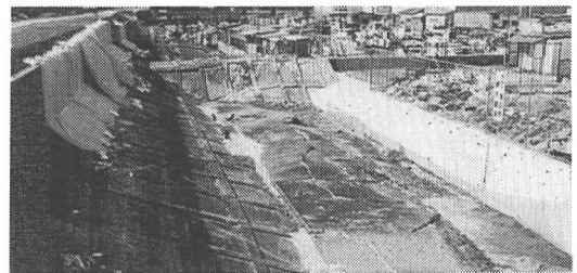
写真-4 淀川右岸の被害状況
