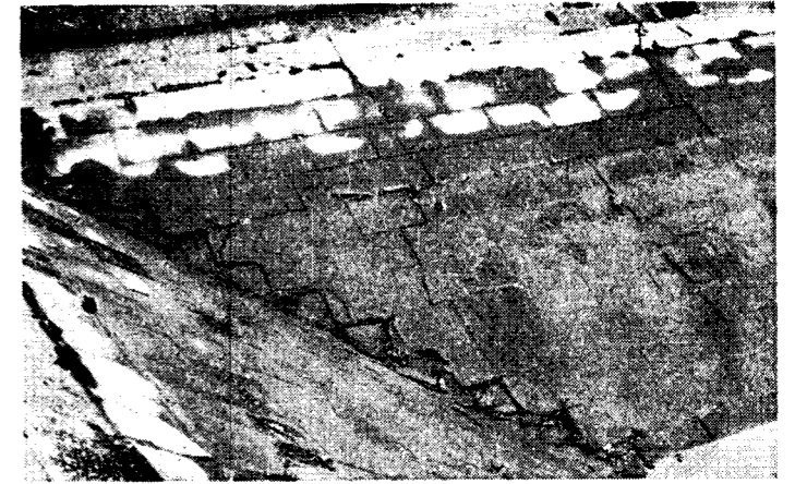
写真-13 今市町浄水場沈殿池の亀裂
