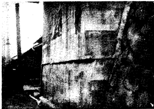
写真-1 今市町内陸線橋橋台の滑動
