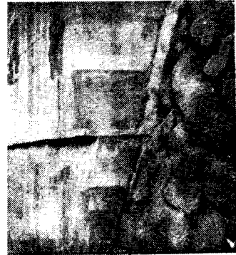
市町内陸線橋橋台の滑動
