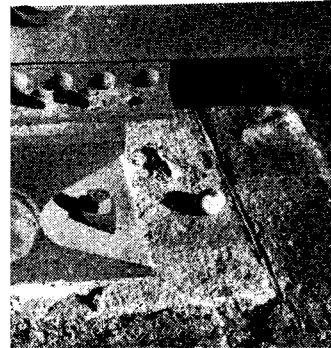
大谷川鉄橋固定支承ボルト切断
