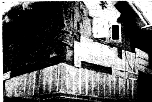
写真-7 板橋石張土蔵被害(今市町)
