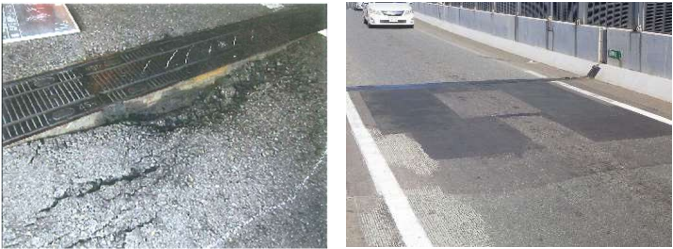
写真-2 舗装の損傷状況
