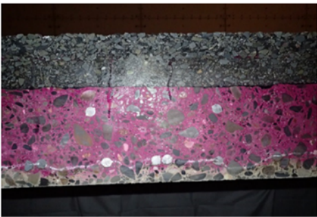
写真-1 床版下面中性化および下段ひび割れ状況
