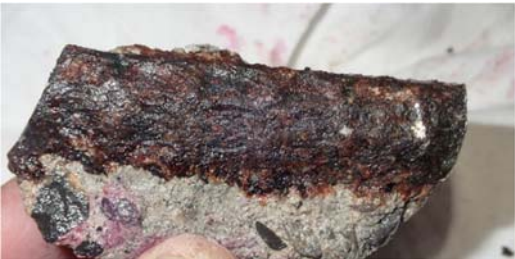
写真-2 下段鉄筋の腐食状況
