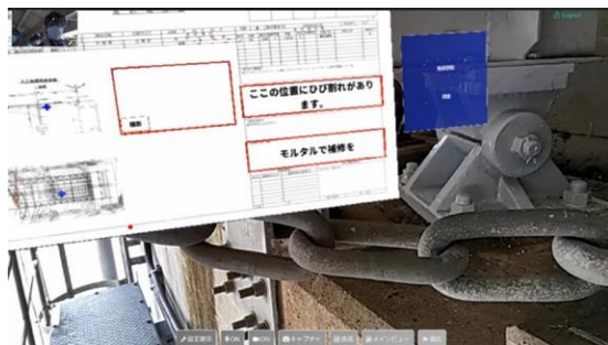
写真-3 変状報告書作成状況
