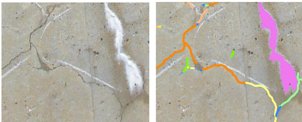
図 1 ひび割れと遊離石灰の検出例（左：入力画像，右，検出結果，ひび割れは幅ごとに色分け）
