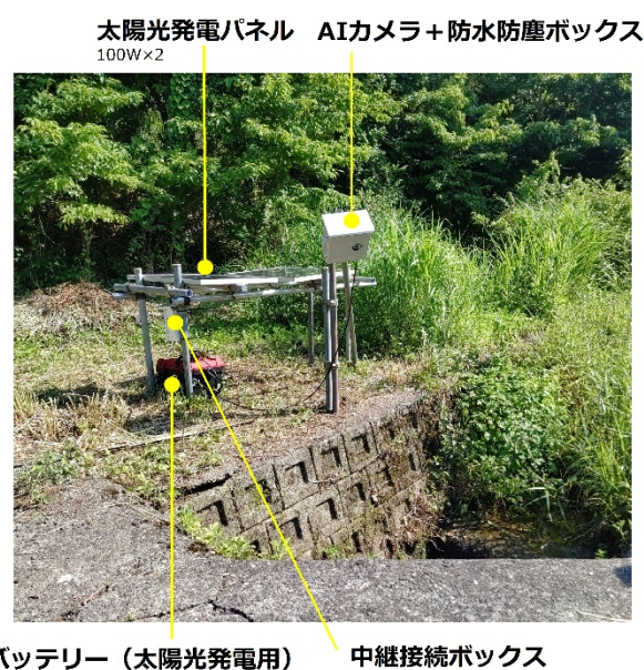
図2 AI カメラ 設置状況写真
