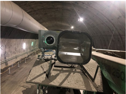
写真 1 吹付け機に搭載した AI カメラ
