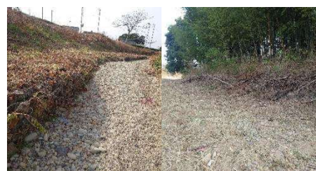
図-2 河床洗堀状態(左)および側岸竹林繁茂区間の洗堀状態(右)
