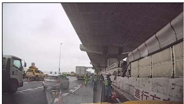
図-5 遮音壁の損傷状況（拡大）
