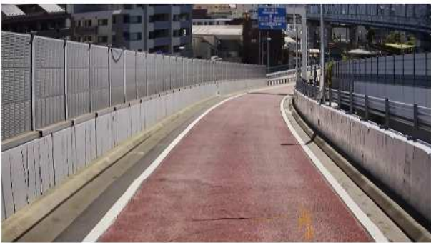
図-6 fps7 ひび割れ検知結果(オレンジハッチング)
