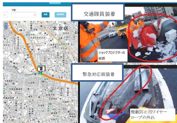
図-5 損傷箇所の詳細把握
