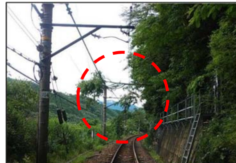
写真-1 倒木被災事例
