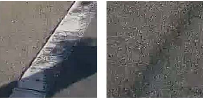
図-2 健全の分割画像を損傷と誤判定した例 (ドラレコ)
