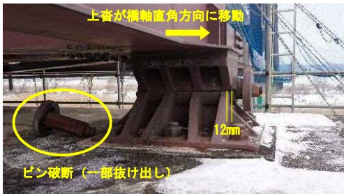
写真-1 調査対象とした支承の被災状況
