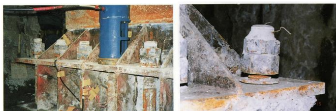
写真-1 アンカーボルトの被害事例 1)
