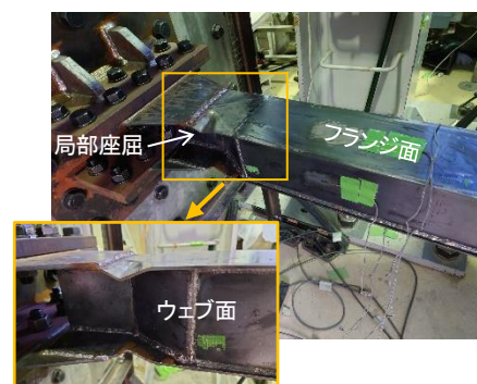
写真-1 载荷終了後の変形状態
