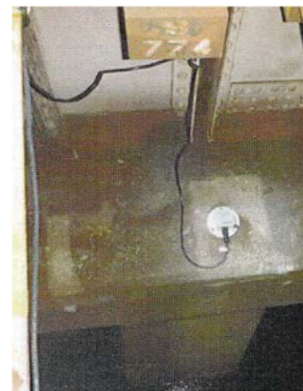
図 2 地震計の設置状況
