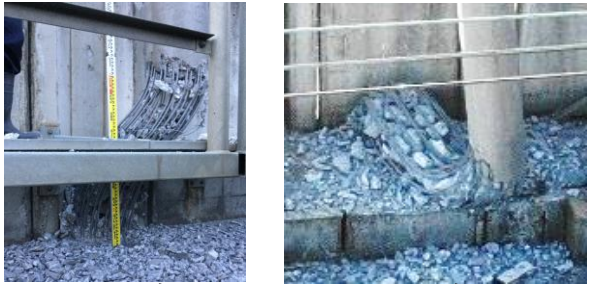
2021年 2022年 図-4 特殊部の電化柱基部の圧壊状況
