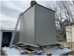
写真-2 SS400 貯水槽
