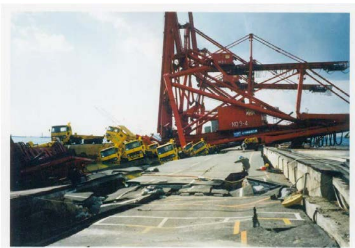
図-4 陸側レール基礎が杭基礎の場合の被災事例 (六甲アイランド RC-3)。陸側レール付近に崖が形成されている。
