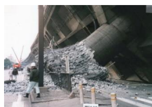
基部の鉄筋が南側にも湾曲、 コンクリート破壊線が柱軸線に直角 図4 P133(東面)軸圧縮破壊
