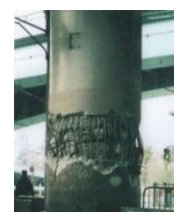
塑性率3程度損壊例 図7 P607の状況
