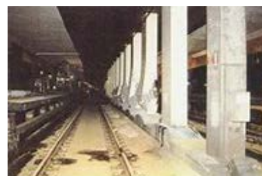
図-3 大開駅の柱の座屈
